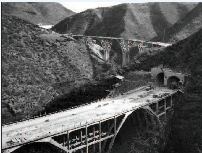
4. I viadotti Poggettone e Pecora Vecchia tra Bologna e Firenze sulla Autostrada del Sole: Arrigo Carè e Giorgio Giannelli con l'Impresa Garbarino, Sciaccaluga, Mezzacane, cantiere del 1959 (archivio Autostrade per l'Italia - Collezione SIXXI)
