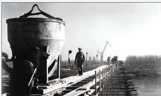
1. Il ponte sul Po a Piacenza tra Milano e Bologna sulla Autostrada del Sole: Silvano Zorzi con l'Impresa Rizzani, cantiere del 1958 (archivio fotografico Autostrade per l'Italia - Collezione SIXXI)
