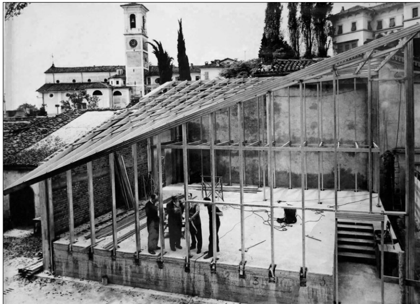
Fig. 4 Biblioteca Benedetto Croce a Pollone. Gustavo Colonnetti ispeziona il cantiere con l'Arch. Leonardo Mosso.
